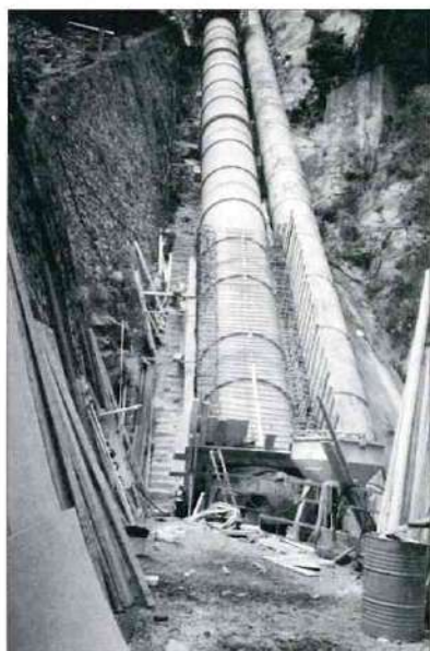
La nouvelle conduite forcée de l'usine E.D.F. de Paganin, lors de son installation, à côté d'une des deux anciennes conservées pour permettre à l'usine de continuer de produire durant les travaux. Photo Louis MAIFFREDI
