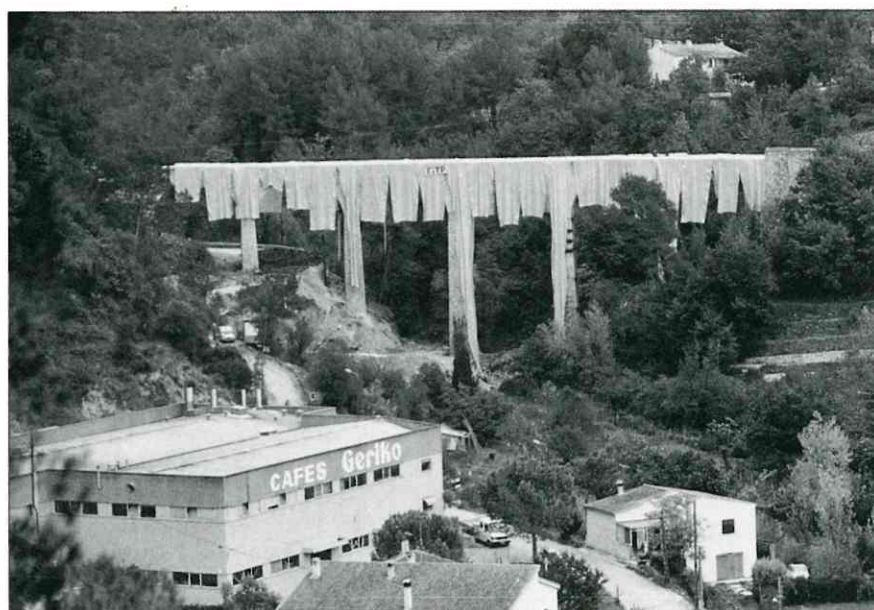
Trois étapes de la démolition à l'explosif du viaduc de la Launa sur la ligne S.N.C.F. Nice-Breil, le 28 octobre 1992. L'ouvrage a été préalablement recouvert de bâches pour éviter les projections de débris. Photos José BANAUDO
