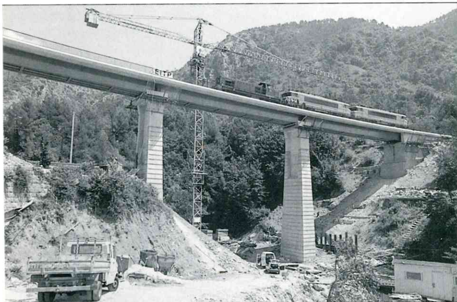
Le 24 juin 1993, en contrebas du vieux village de Peillon, un convoi de locomotives électriques remorquées par une machine diesel procède aux essais du nouveau viaduc de la Launa sur la ligne S.N.C.F. Nice - Breil-sur-Roya. Photo José BANAUDO
