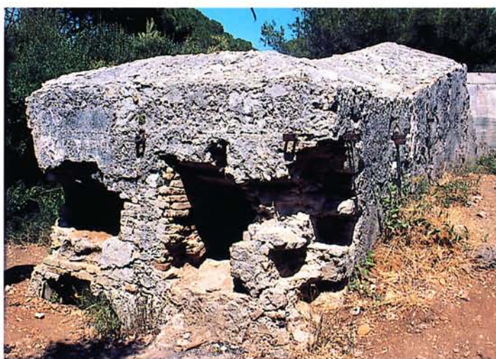
Fig. 5 - Îles de Lérins. Four à boulets de la pointe du Dragon. Le pillage des chaînes d'angle entraîne la ruine de la façade.
